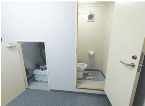
トイレ裏のポンプ室に設置
