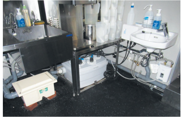
作業台下に設置
